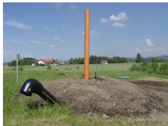
Abbildung: Umgebauter Biofilter 3 mit Abgaskamin, Rohgas-Probenahmestelle und Zuluftrohr
