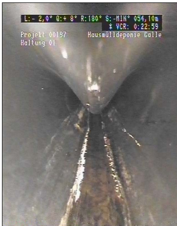
Bild 1: Rohrverdrückung in der Sickerwasserhauptleitung
